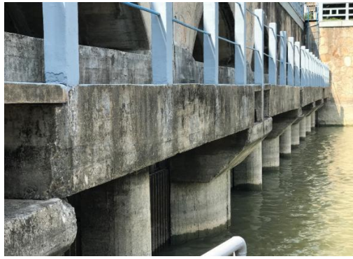
工作桥局部裂缝碳化
