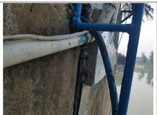
翼墙不均匀沉降与错位
