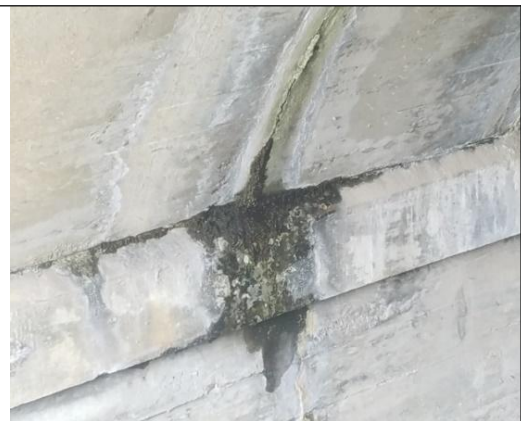
3#孔拱片右侧近拱脚处接缝渗水
