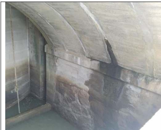
2#孔拱片左侧近拱脚处接缝渗水
